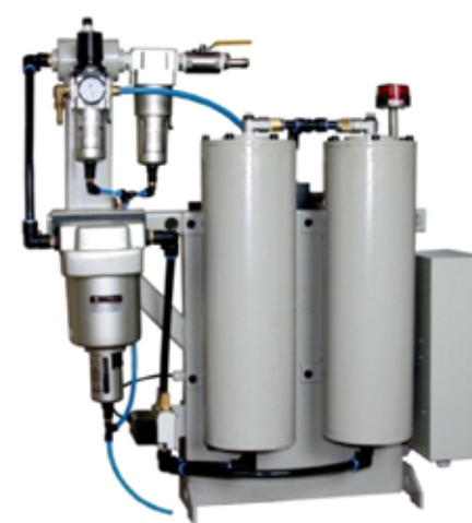
Станция осушки и очистки сжатого воздуха
